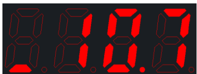
1#水泵电流值 (单位: A)
